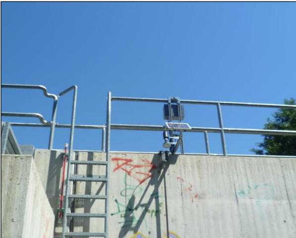
Bild 5: Beispiel für Wasserstandsmessung mittels Radar am Hochwasserrückhaltebecken Kaitzbach 3
